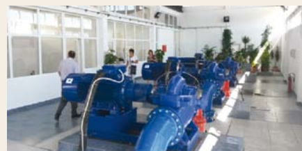
Nove pumpe u crpnoj stanici
